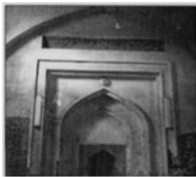
محراب مسجد جامع قبل از برداشتن اندودهای اضافی، مأخذ: (آرشیو سازمان میراث فرهنگی، صنایع دستی و گردشگری استان آذربایجان شرقی)
