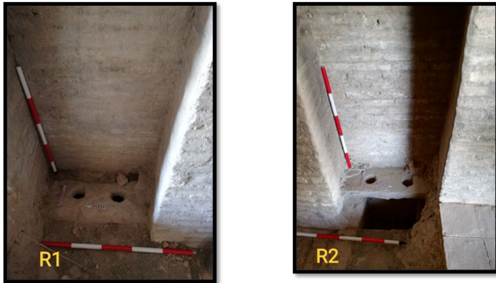
تصویر ۷: مخازن R1 و R2 در ضلع شرقی و غربی طبقه اول برج آب. فضای مخزن در تصویر سمت راست قابل مشاهده است (نگارندگان، بهار ۱۳۹۹) Figure 7: Reservoirs R1,R2 on the east and west sides of the first floor of the water tower. The reservoirs space can be seen in the image on the right (Authors 2020)
