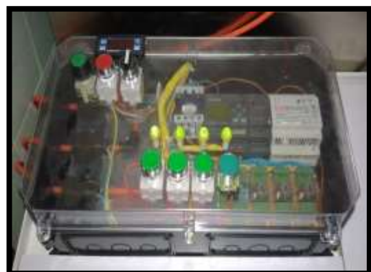
شکل ۴- جعبه مدار فرمان و قدرت شامل (پی‌ال‌سی، منبع تغذیه، شیرهای برقی، رله‌ها، کنتاکتور و سویچ‌های اصلی و فرمان)
