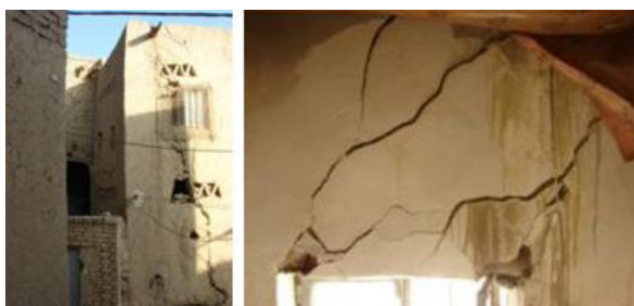
تصویر ۳- وجود ترک‌های قطری در نما و دیوارهای داخلی.
