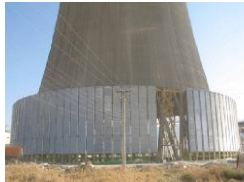
شکل ۴: سازه دریچه متصل به یک برج خنک کن.
