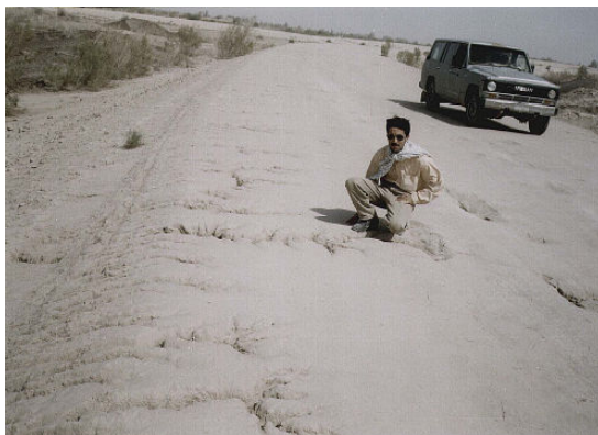
شکل ۴- قسمتی از بدنه در حال تخریب یک گوره
